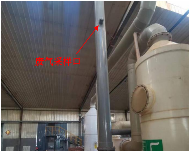
废气采样口照片
